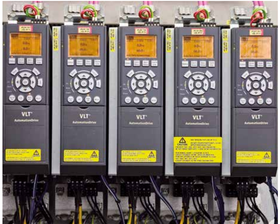
Der Einsatz von Frequenzumrichtern ist heute Stand der Technik und findet immer mehr Verbreitung. Von den ca. 75 Millionen in Europa installierten Motoren wird bereits ca. jeder Achte drehzahlregelt.
