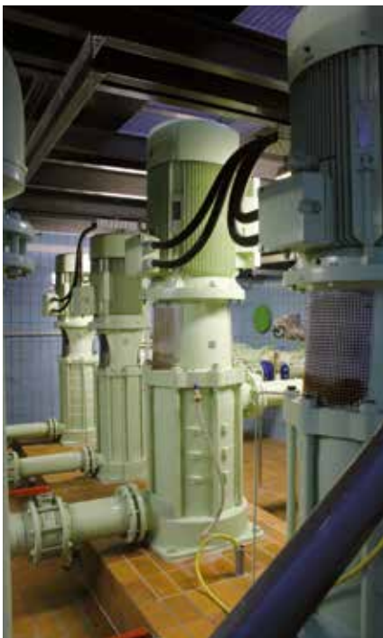
Die Reduzierung der Drehzahl um 20 % kann bei Pumpenanwendungen im Idealfall die Energiekosten um bis zu 50 % senken
